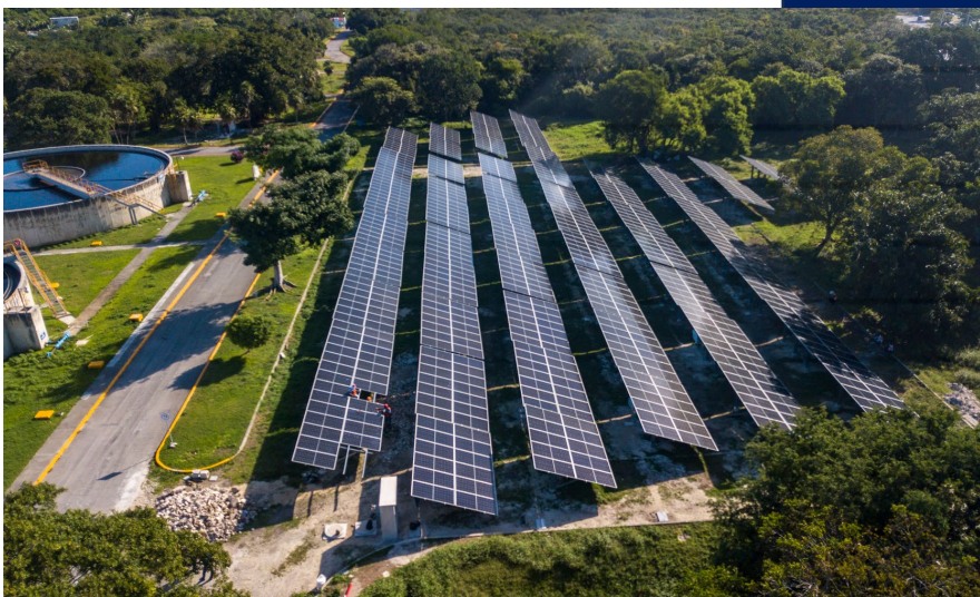
Instalación solar en PTAR Norte
