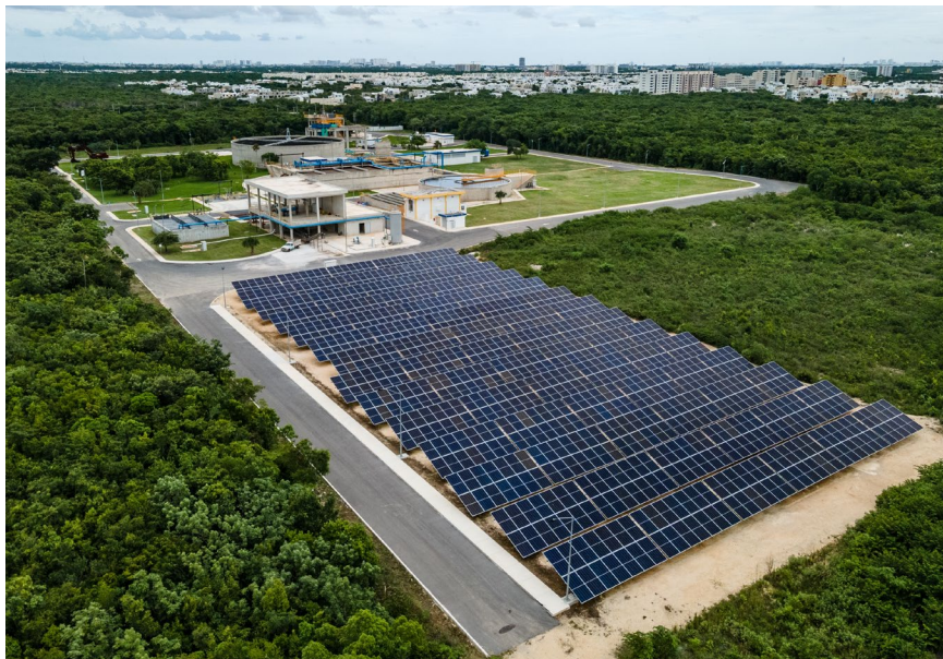
Instalación solar en PTAR Sur
