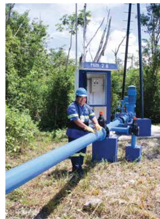
Operador de Zona de Captación
